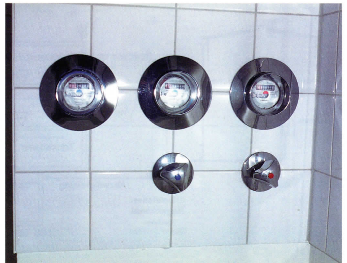
Bild 6. In den 80 Wohnungen, die das aufbereitete Niederschlagswasser für Toilettenspülung und Bewässerung des Mietergartens erhalten, ist zusätzlich zu den üb- lichen Kalt- und Warmwasserzählern (Trinkwasser) ein Regenwasserzähler installiert (links). Das ermöglicht die Abrechnung von separaten Gebühren. (Foto: Klaus W. König)
