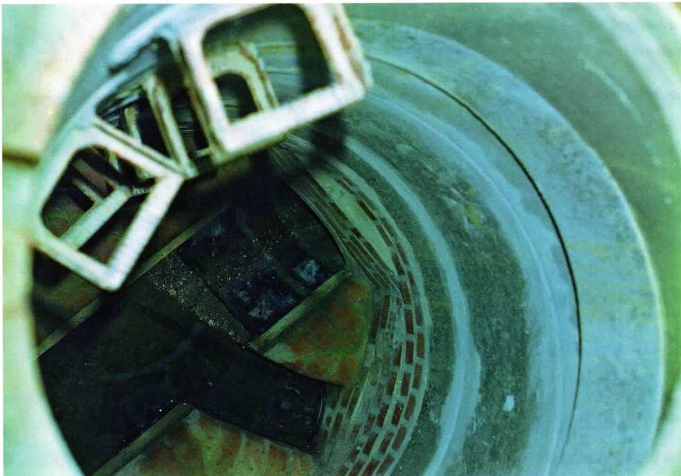
Bild 1. Source-Control statt End-of-Pipe-Lösung: In diesem Abzweigschacht läuft Niederschlagswasser mit allen, was nicht in die Spree gehört, Richtung Zisterne. Auf dem Weg dorthin sind Schlammfang, Sedimentation und Flotation wirkungsvoller, als in weit entfernten zentralen Regenrückhaltebecken. Und nebenbei entsteht hier jede Menge nutzbares Betriebswasser. (Foto: Klaus W. König)
