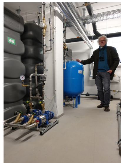
Links der sechsteilige Vorratsspeicher für das Betriebswasser. Vorne die Druckerhöhungsanlage, die nach Bedarf mit fünf bar die Toilettenspülung in den 399 Apartments versorgt. Hinten (blau) der Druckausgleichsbehälter. Er sorgt dafür, dass nicht bei jeder einzelnen Spülung die Pumpen anspringen
