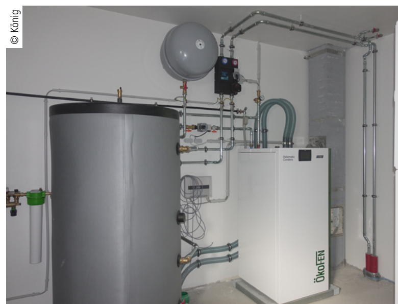
Abb. 4: Brennwert-Holzpelletkessel des Herstellers ÖkoFEN. Links Pufferspeicher für das erwärmte Heizungswasser, um die Anzahl der Brennerstarts zu senken.
