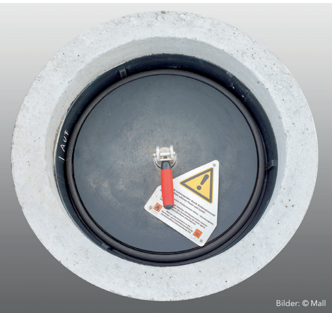
| Bild 4 | Einstiegöffnung von oben. Zweite Dichtebene mit PE-Deckel und Hinweis zur Sicherheit in Bezug auf CO-Messung beim Einstieg
